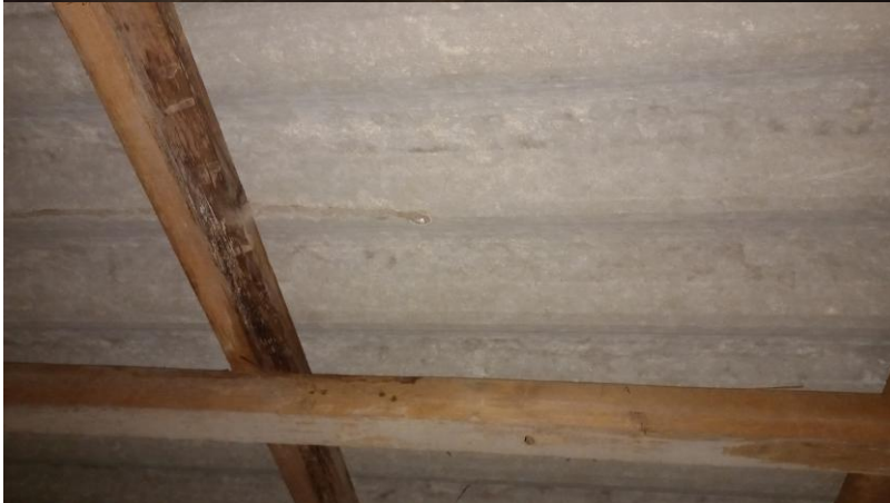
Telhas a serem trocadas
