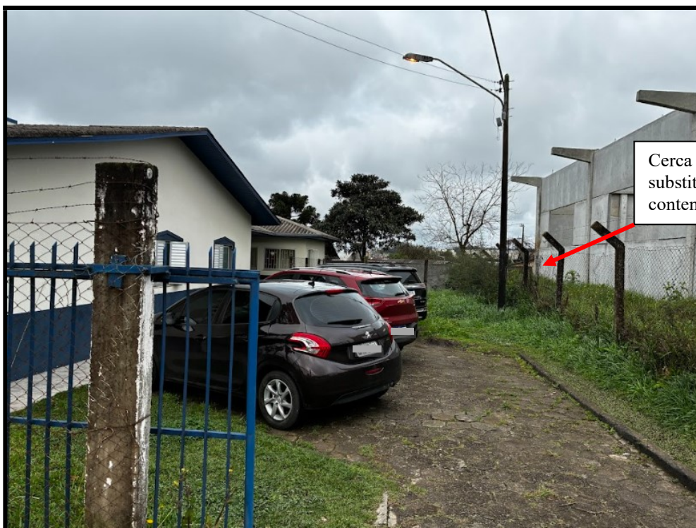
Foto 02 – Fundos e lateral direita da edificação (local onde será feito a ampliação)
