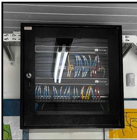
Imagem 03 – Rack com visor acrílico existente no local
