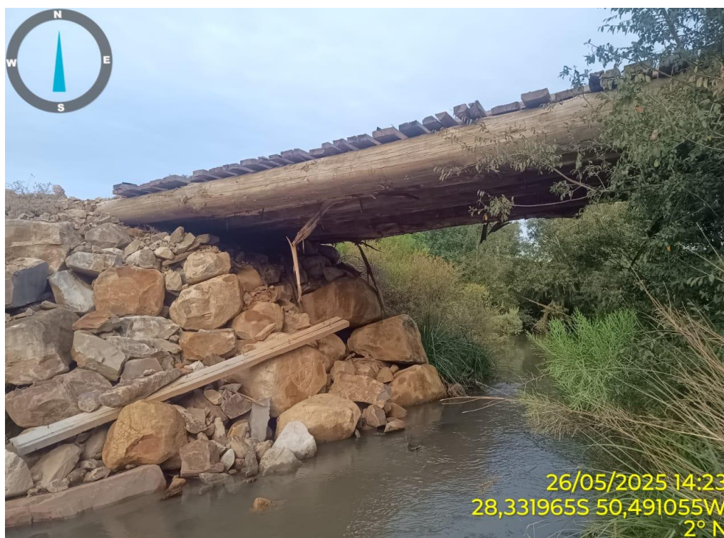
Foto 6: Exemplo de enrocamento a ser adotado, mostrando a disposição das pedras utilizada para estabilizar a margem e proteger os apoios da estrutura.
