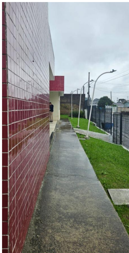
Fotografia 03 – Fachada com revestimento cerâmico.
